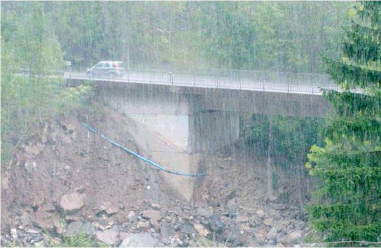
Abb. A4-19: Durch Erosion abgerissene Trinkwasserleitung (Amt der Vorarlberger Landesregierung 2005, S.23,31)
