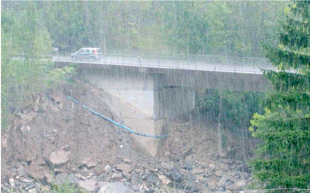
Abb. A4-7: L 200 Bregenzerwaldstraße, Sporeneggbrücke mit abgerutschter Trinkwasserleitung (Amt der Vorarlberger Landesregierung 2005, S.31)
