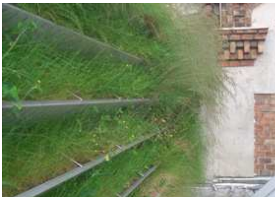
Abb. A_F- 10: Fassadenbegrünung mit dem Grünwand-System (Quelle: Tech Metall, 2011)
