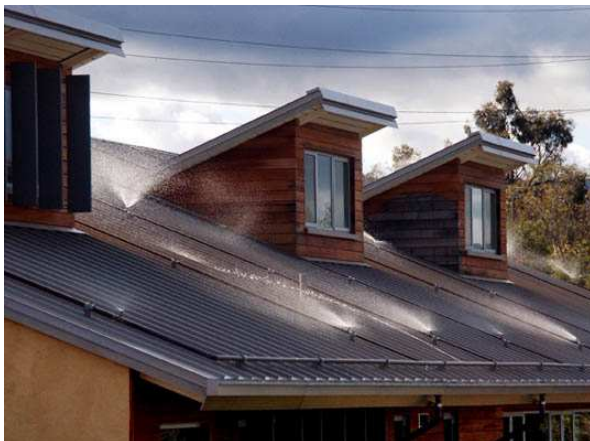
Abb. A_F- 12: Verwendung von Sprühnebel auf dem Dach des Department of Global Ecology, Stanford (Quelle: Carnegie Institution for Science, 2011b)
