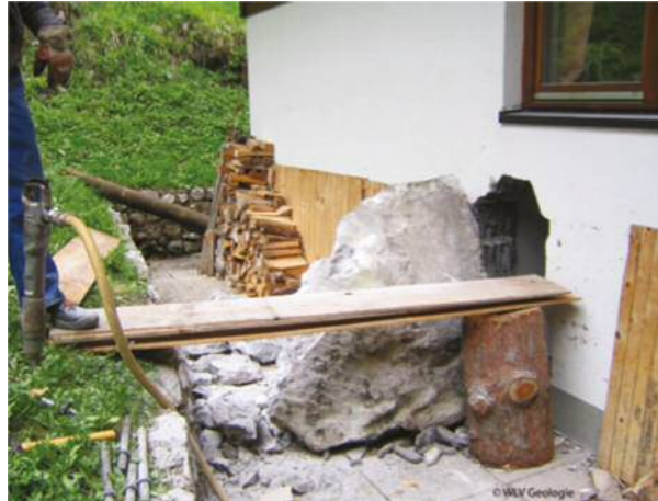
Abb. C- 2: Gebäudeschäden durch Naturgefahren, Quelle: WLV Geologie
