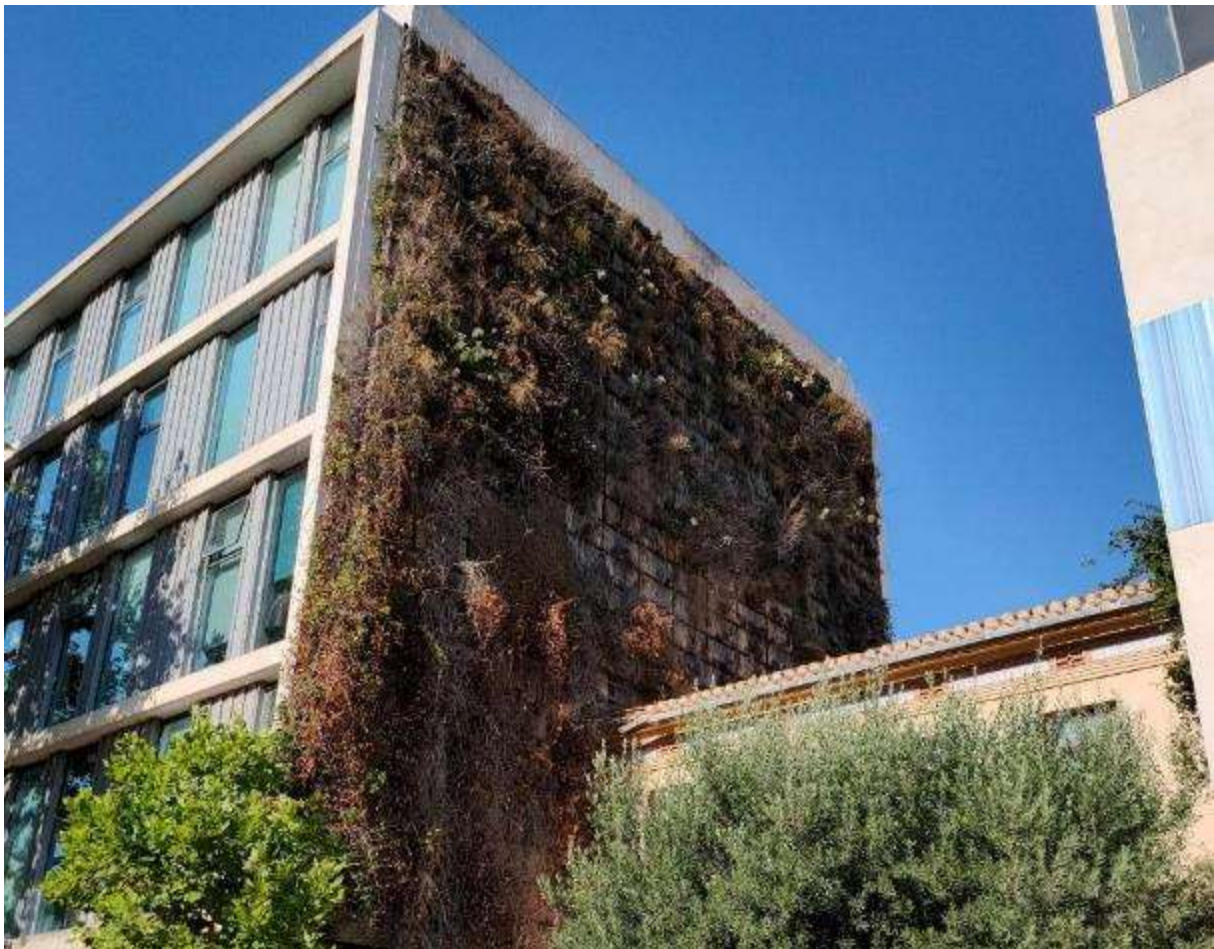
Abb. I-1: Grüne Wand in mit ausgeprägten Schadstellen im Zentrum, Valencia; Foto: M. Pointl (2022)
